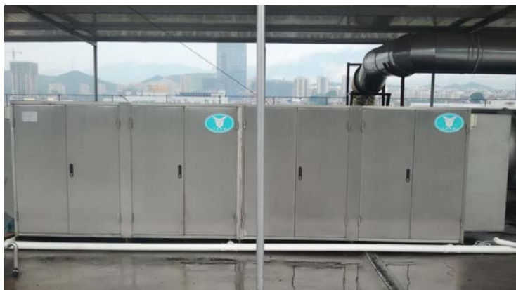
浙江某化工企业设计的工业废气处理示范装备现场工作照片
